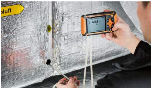
Pomiar przepływu powietrza za pomocą rurki spiętrzającej.
